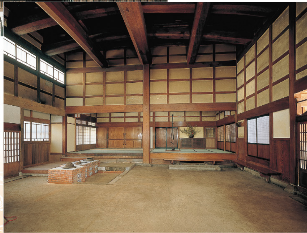
土間から見上げる豪壮な梁組は圧巻です。現代では不可能と言われるその材料の調達。当時が偲べます。
